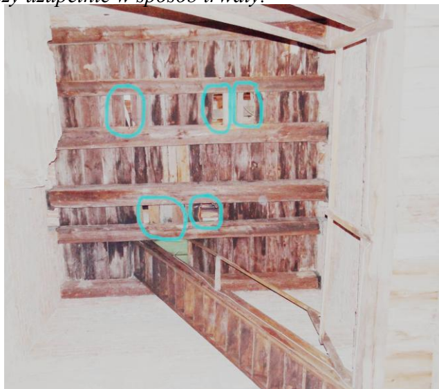
Fot. nr 25. Strop II kondygnacji wieży. Widok od spodu. Zaznaczono brakujące deskowania
