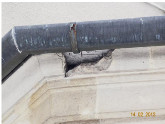
Fot. nr 27. Gzyms – ubytek kamienia.
