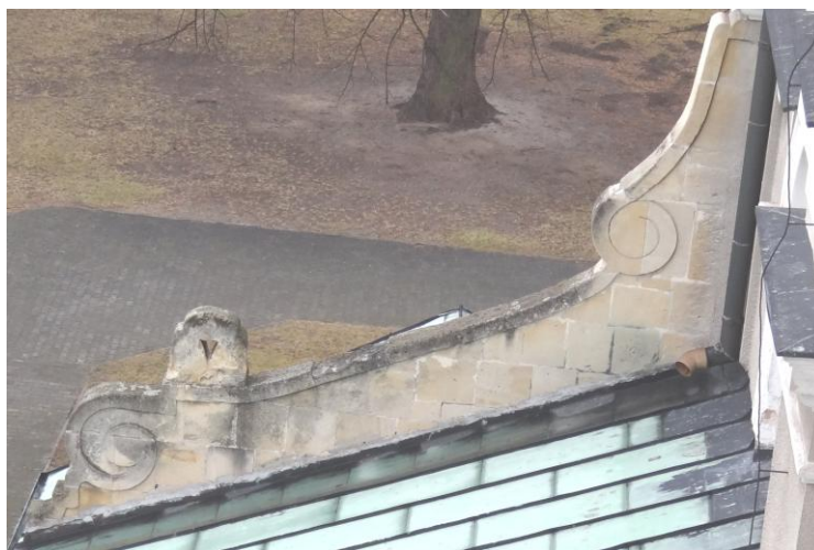
Fot. nr 16. Dach nad absydą nawy południowej - spływ wolutowy bez osłony.
