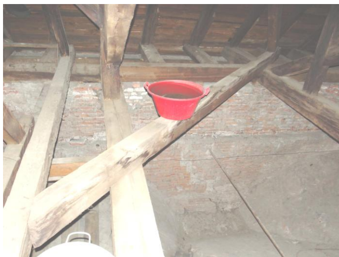
Fot. nr 13. Poddasze. Naczynia zbierające przeciekającą wodę
