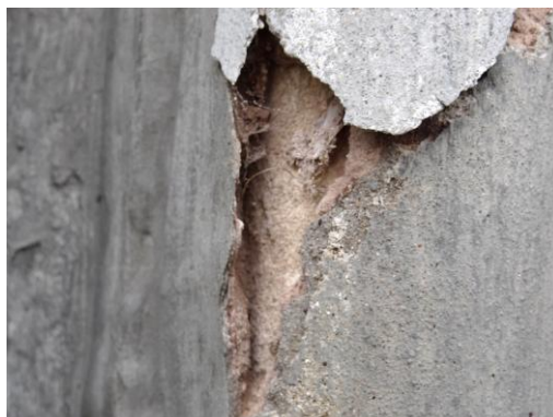
Fot. nr 5. Fragment elewacji zachodniej. Widoku zmurszałego tynku
