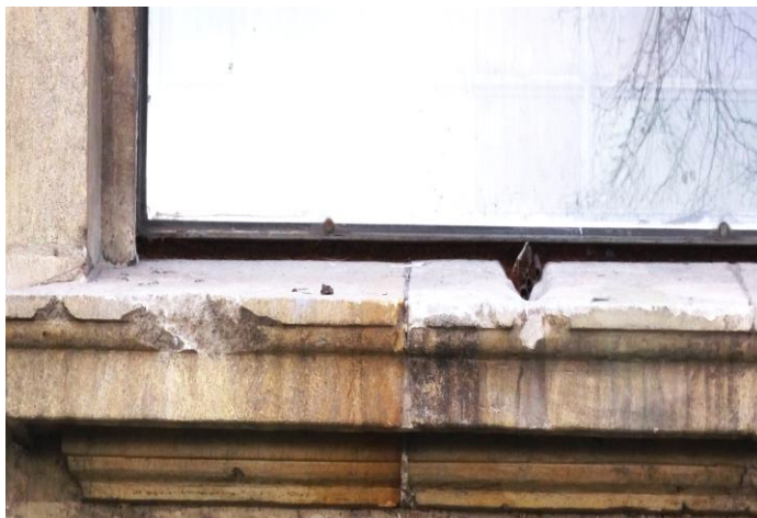
Fot. nr 31. Parapety podokienny – ubytki kamienia
