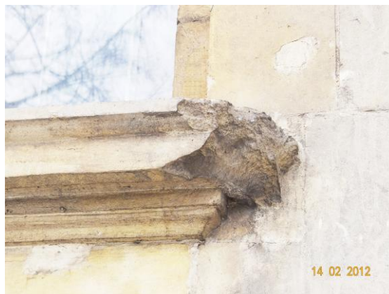
Fot. nr 28. Parapet podokienny – uszkodzenie, ubytek kamienia
