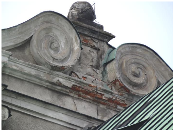
Fot. nr 15. Fragment ściany szczytowej nad łukiem tęczowym (ściana dzieląca prezbiterium od nawy głównej).
