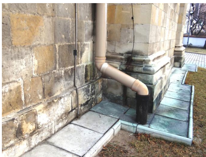
Fot. nr 19. Rury spustowe . Blacha miedziana zamieniona na PCV Brak rewizji. Przewody zakorkowane. Woda przelewa się na zewnątrz.
