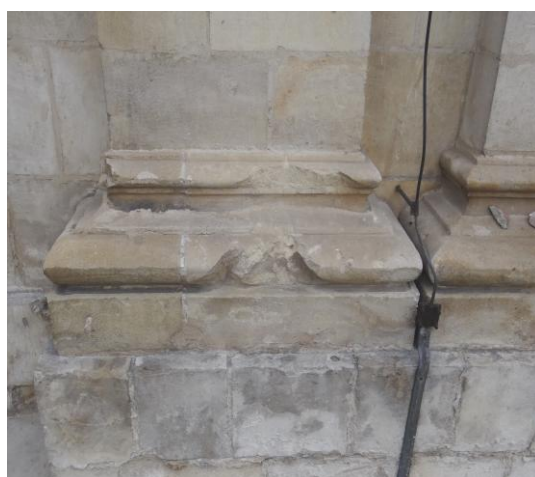
Fot. nr 33. Cokół – ubytki kamienia
