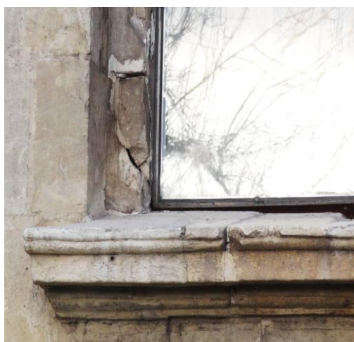
Fot. nr 32. Ościeże – uszkodzenie oblicówki
